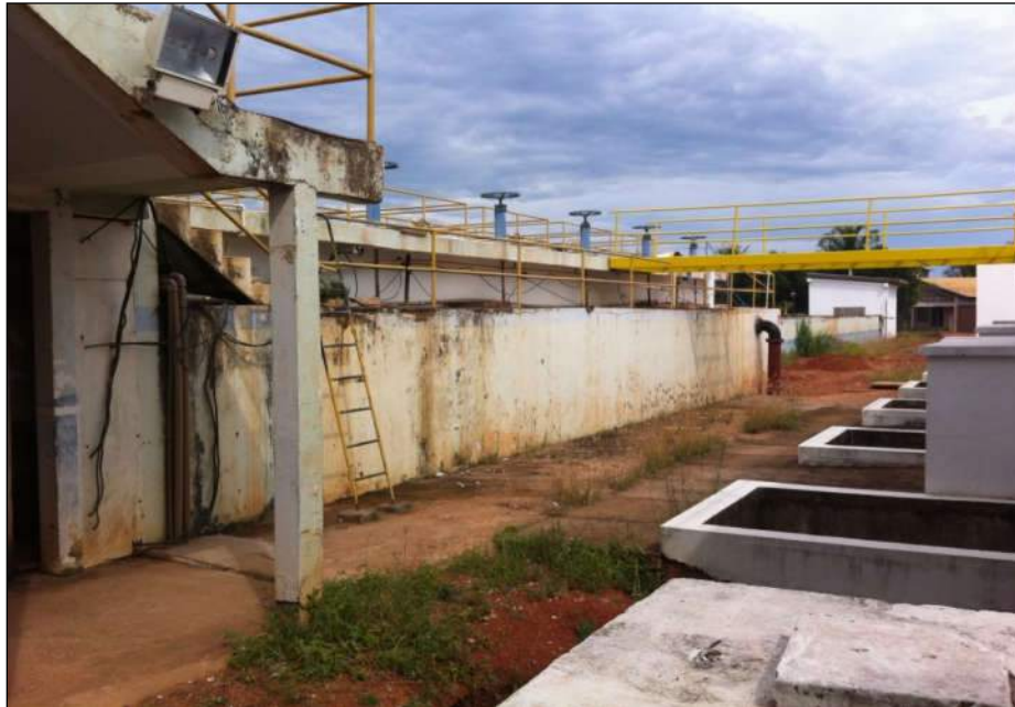
Figura 3.54 – Tanque de contato da ETA I.
