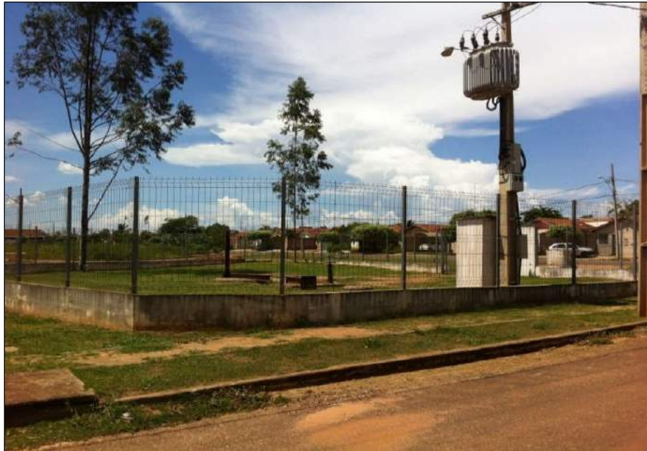
Figura 3.74 – Estação elevatória de esgoto - Parque das Rosas.
