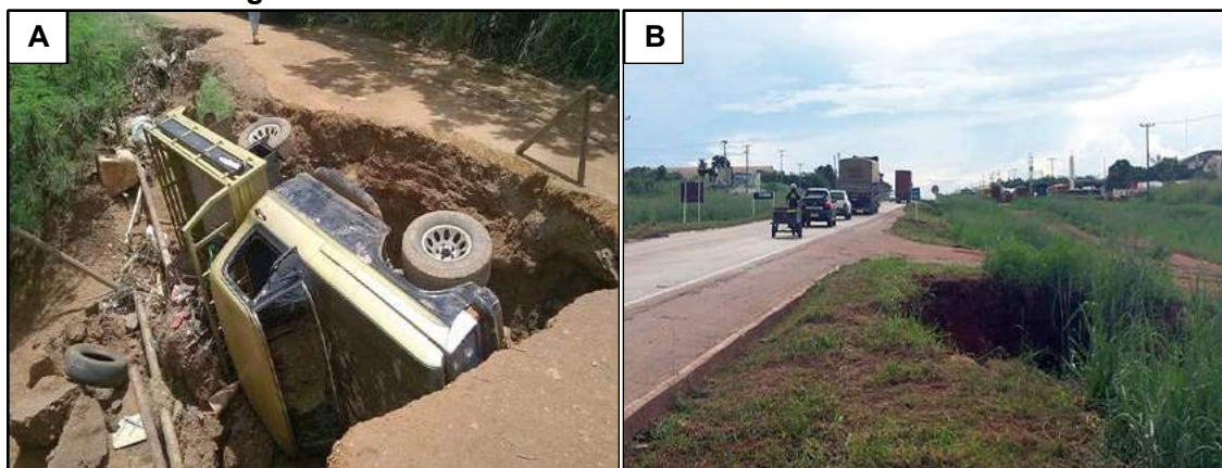
Figura 3.147 – Erosão no Jardim Liberdade e na BR-364.
