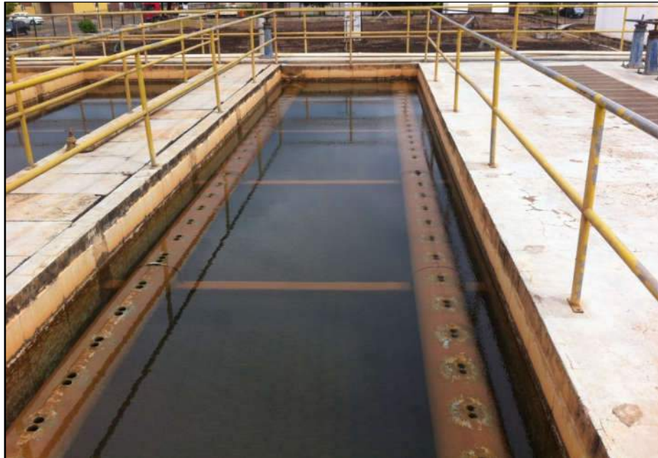
Figura 3.52 – Decantadores da ETA I.
