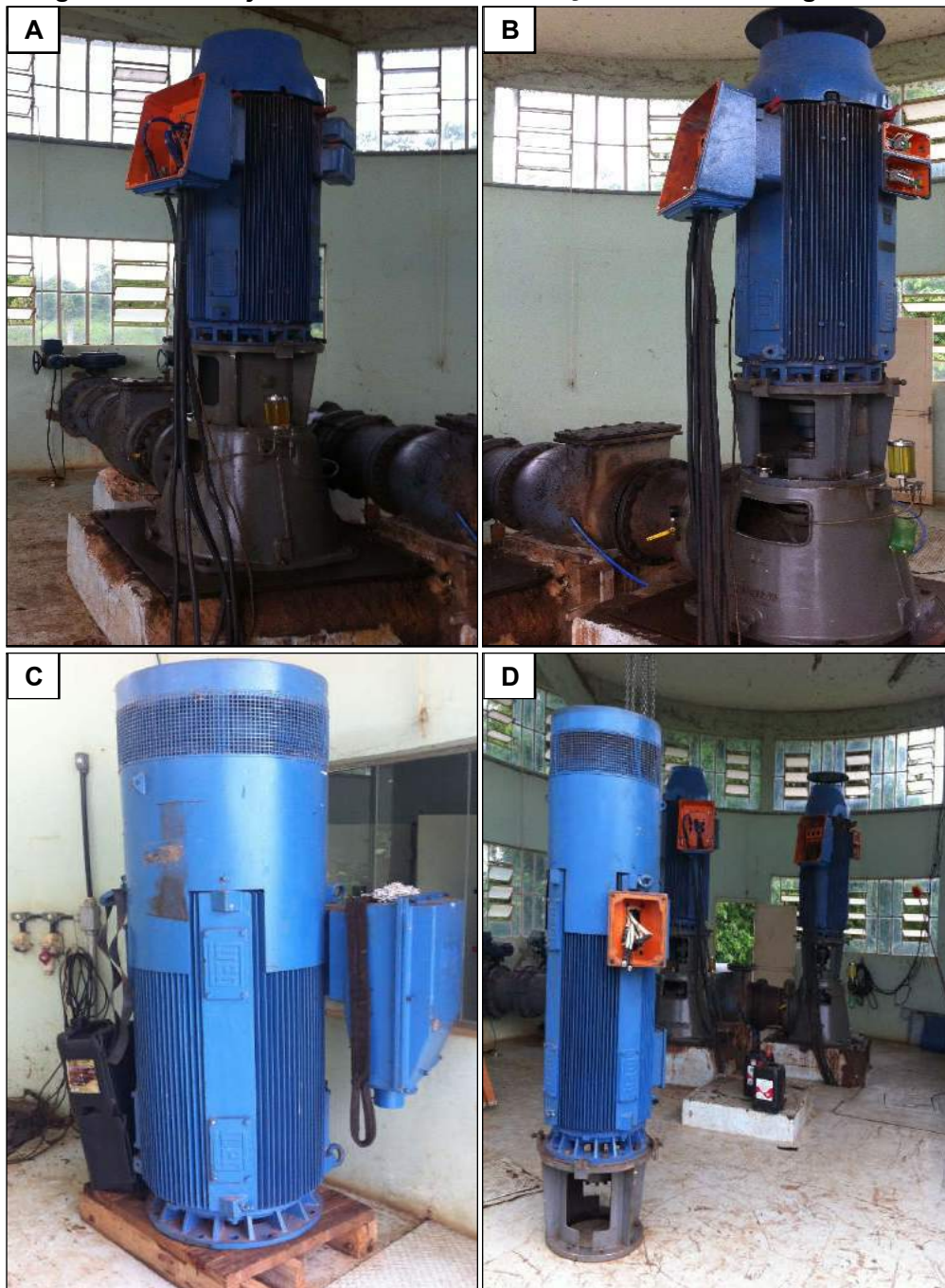
Figura 3.47 – Conjuntos de bombas da estação elevatória de água bruta.
