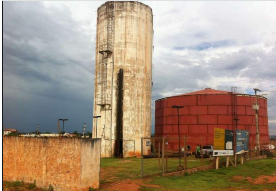
Figura 3.66 – Reservatório elevado e reservatório apoiado do aeroporto de Rondonópolis.
