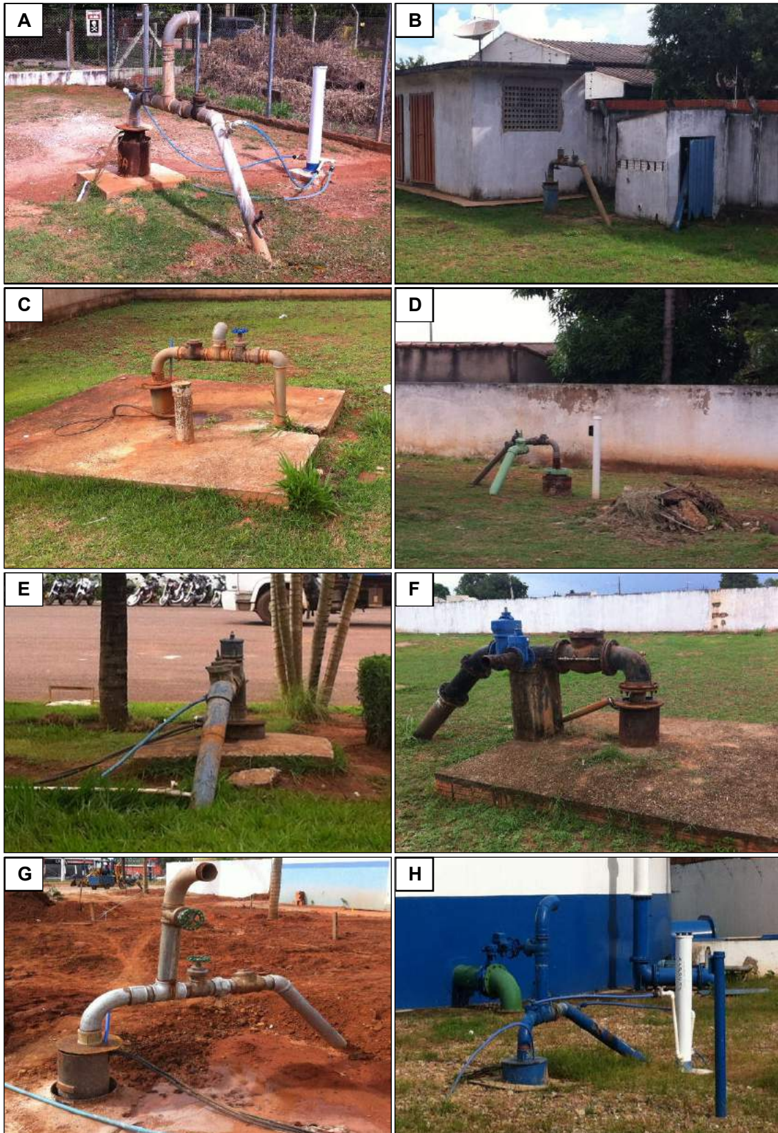
Figura 3.42 – Poços de captação de água subterrânea.
