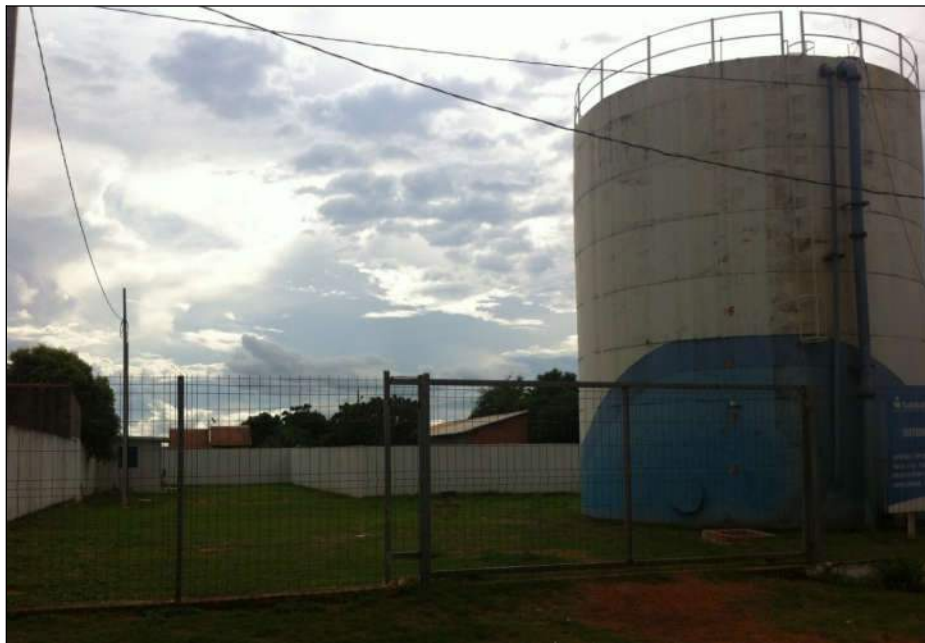
Figura 3.69 – Vista frontal do reservatório - Parque Universitário.
