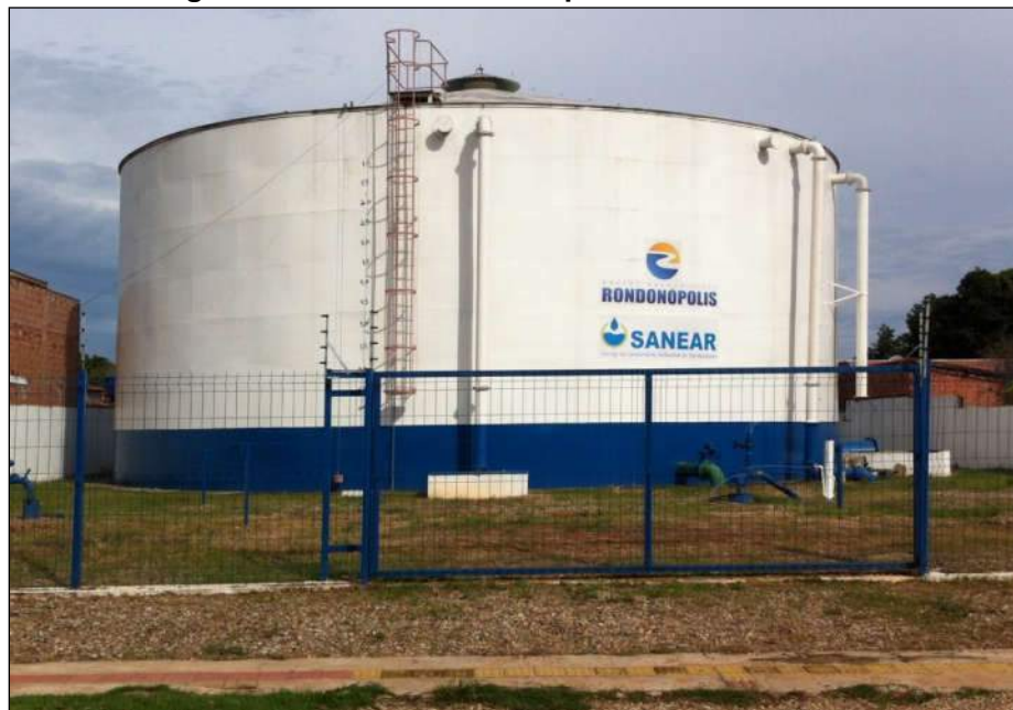
Figura 3.72 – Reservatório apoiado - Vila Mariana.
