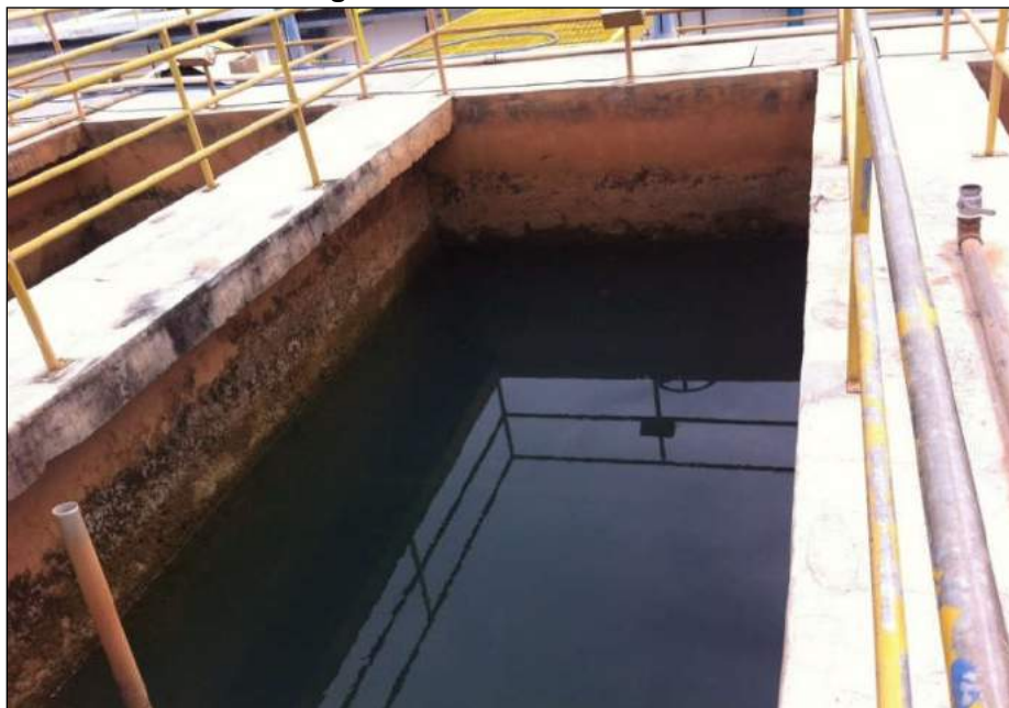
Figura 3.53 – Filtros da ETA I.
