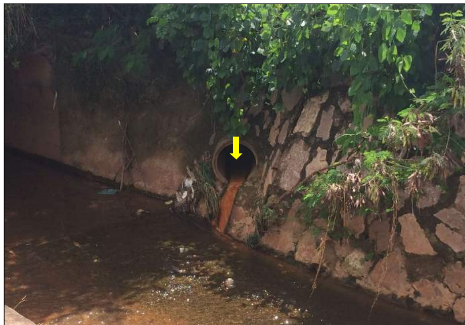
Figura 3.85 – Lançamento de esgoto na galeria de água pluvial do Córrego Patrimônio.
