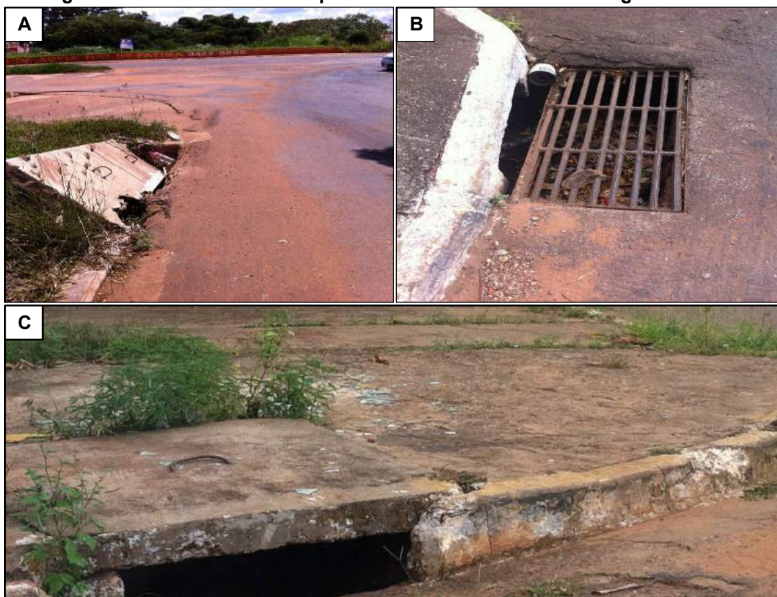
Figura 3.135 – Bocas de lobo quebradas e/ou obstruídas e sem gradeamento.
