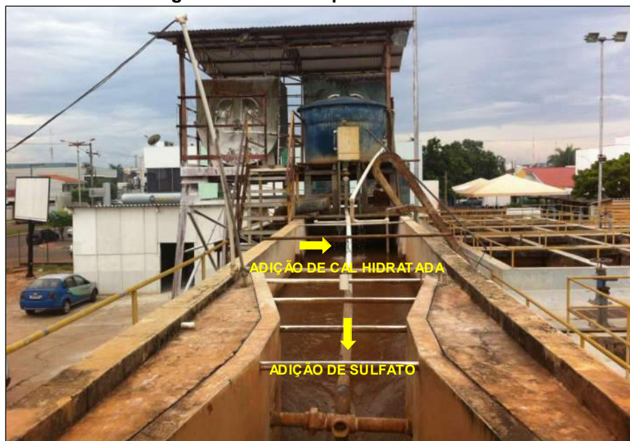
Figura 3.50 – Calha parshall da ETA I.
