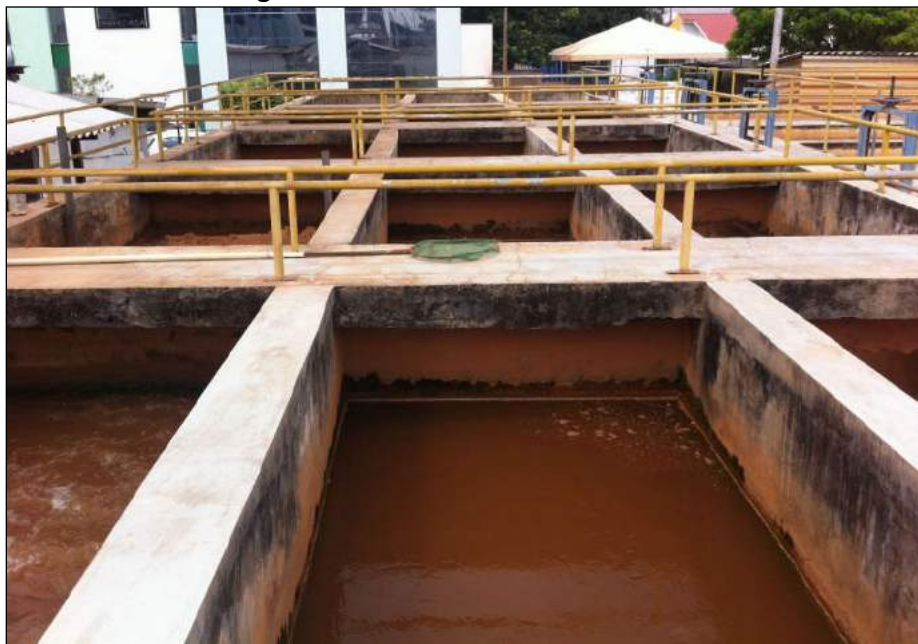
Figura 3.51 – Flocladores da ETA I.
