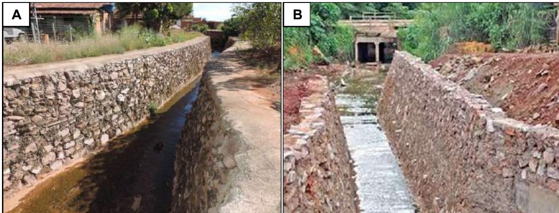
Figura 3.140 – Canalização inacabada do Córrego Canivete.
