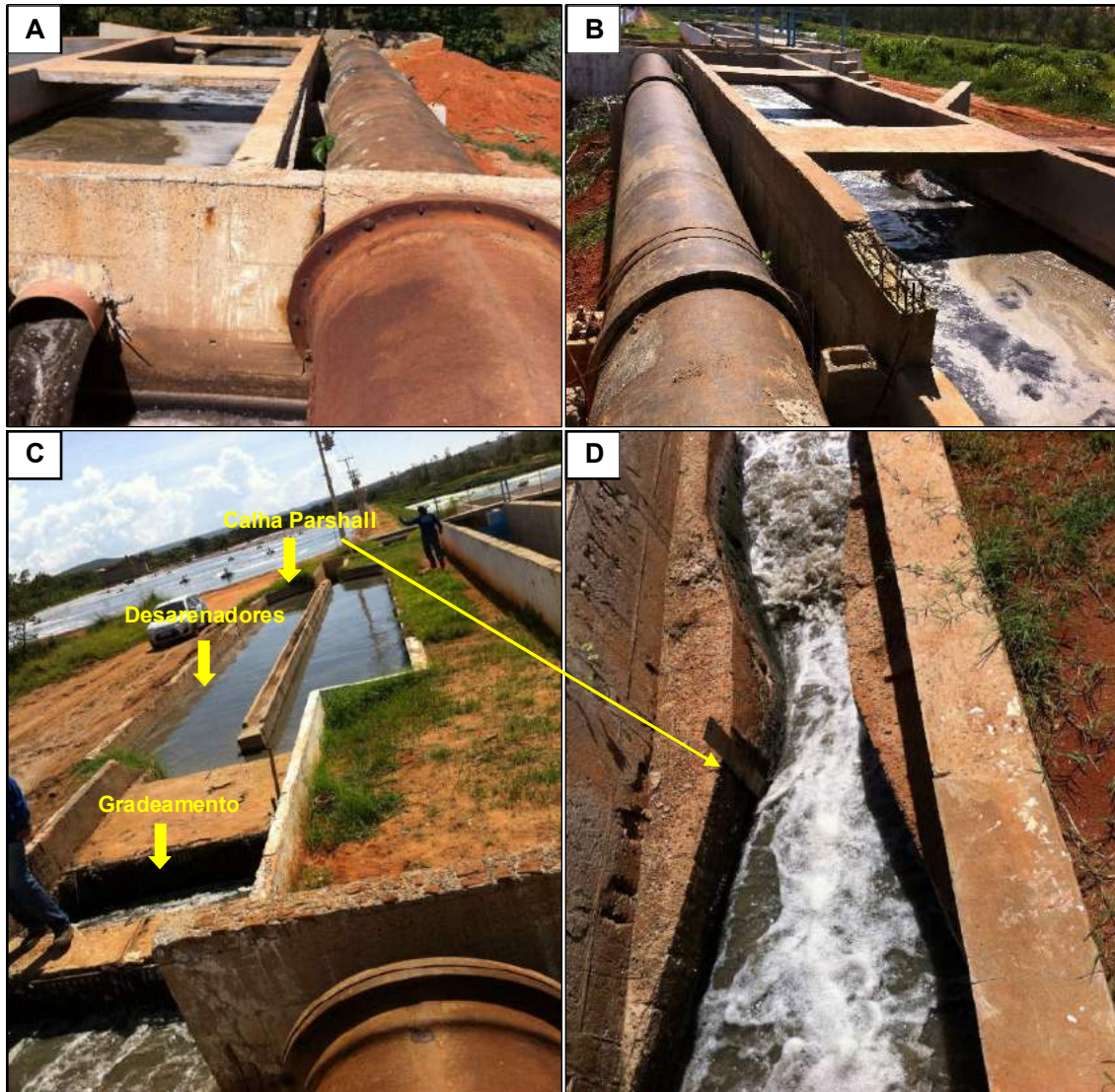
Figura 3.78 – Entrada do esgoto bruto - Tratamento preliminar (sistema velho).
