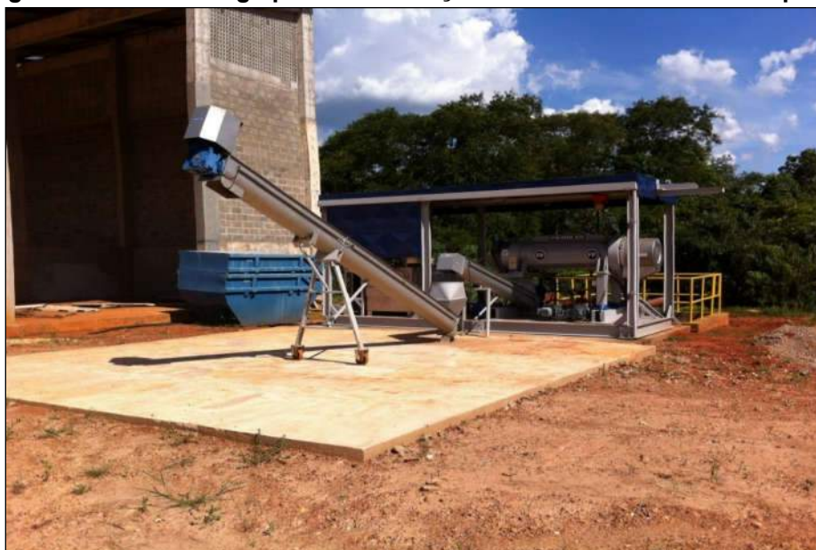
Figura 3.83 – Centrífuga para desidratação do lodo da ETE Rondonópolis.
