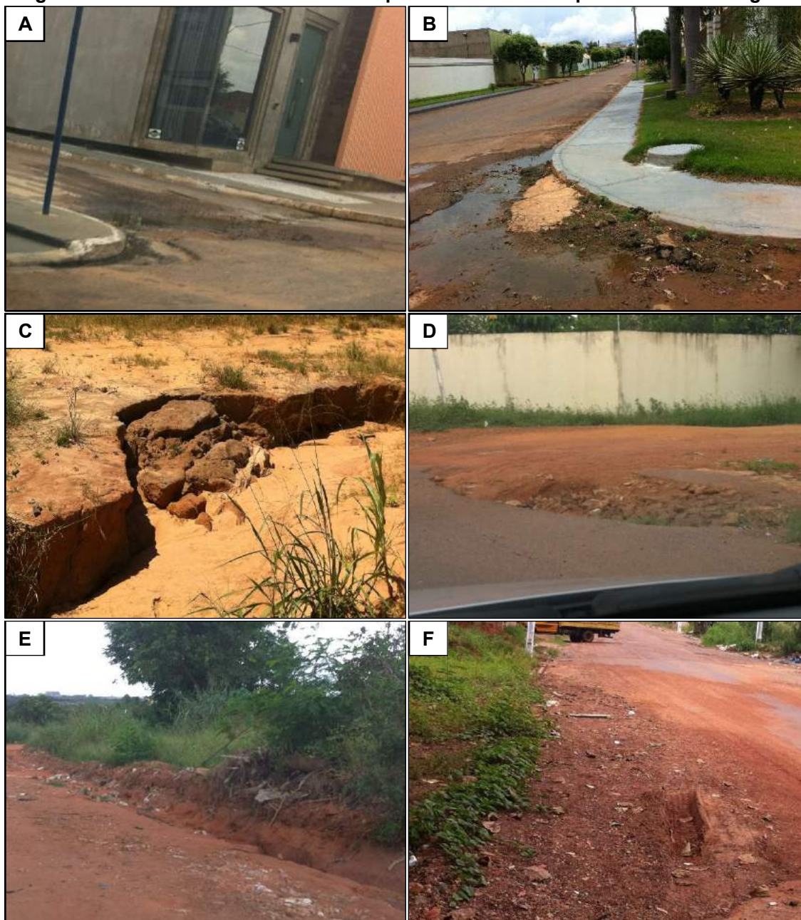
Figura 3.141 – Problemas ocasionados pela ausência de dispositivos de drenagem.
