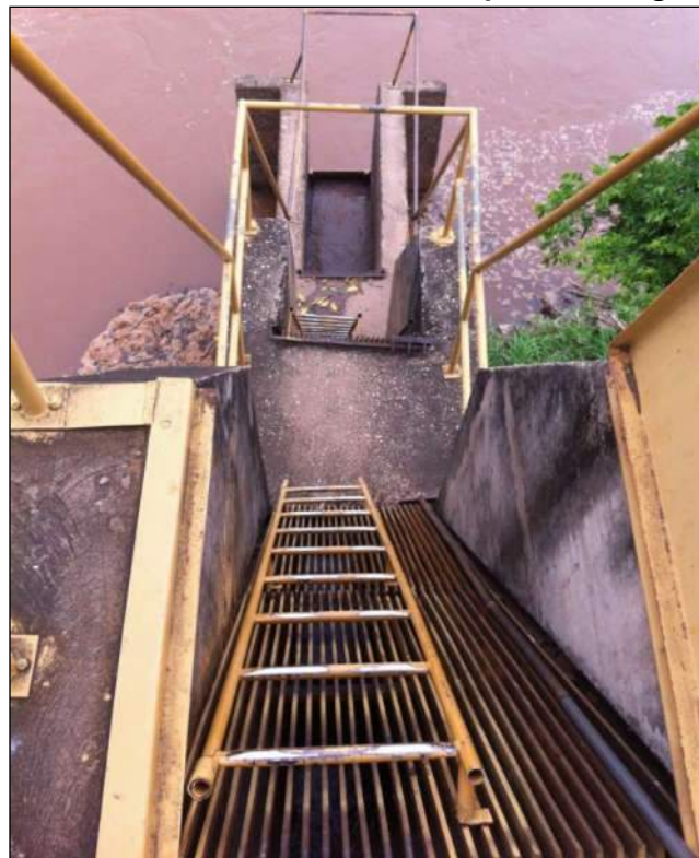
Figura 3.44 – Gradeamento da estação de captação de água superficial.
