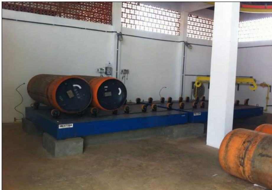
Figura 3.55 – Cilindros de cloro gasoso para desinfecção da água tratada na ETA I.
