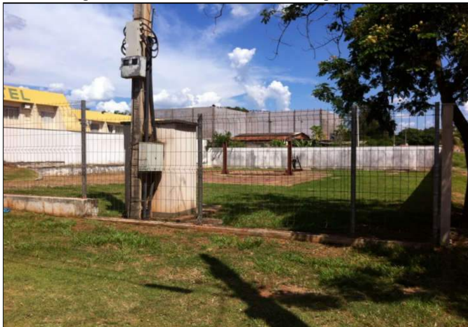
Figura 3.76 – Estação elevatória de esgoto - Lions.
